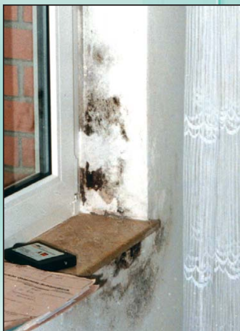
Поява на мухъл около прозорците, причинен от конденз.
